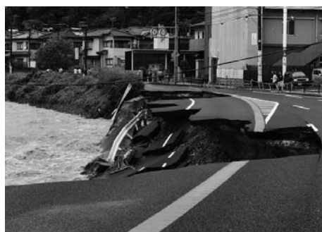
えぐりとられた国道2号線（広島市安芸区瀬野川）
